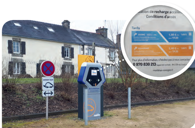
# Borne de recharge, place Ernest Le Moine
