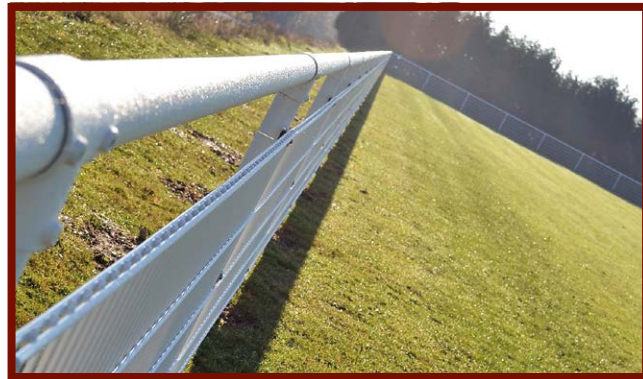
Ces nouvelles mains courantes sont équipées du système DB Stop anti bruit, qui limite les nuisances sonores pour les riverains.
